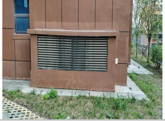
地下室出风口
