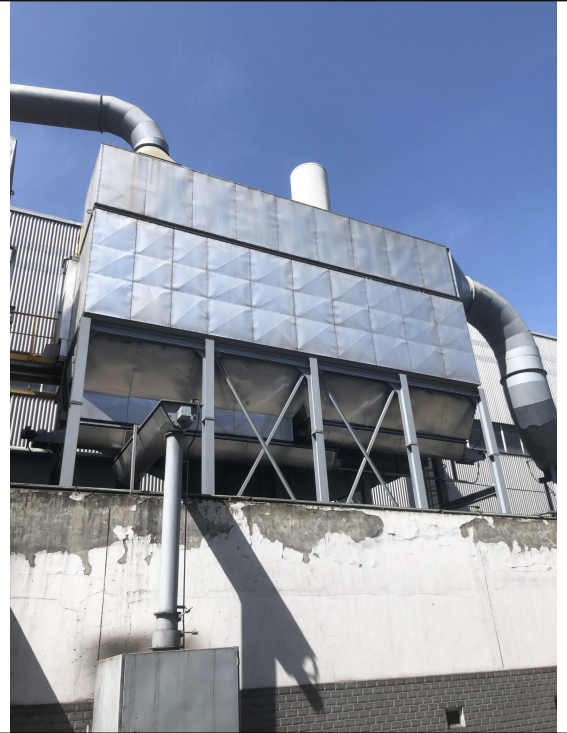
造型、浇注烟尘处理设施(TA005)+排气筒 (DA005)
