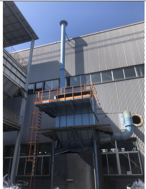
清理工部抛丸砂磨粉尘处理设施“旋风除尘器+布袋除尘器”(TA001)+排气筒(DA001)
