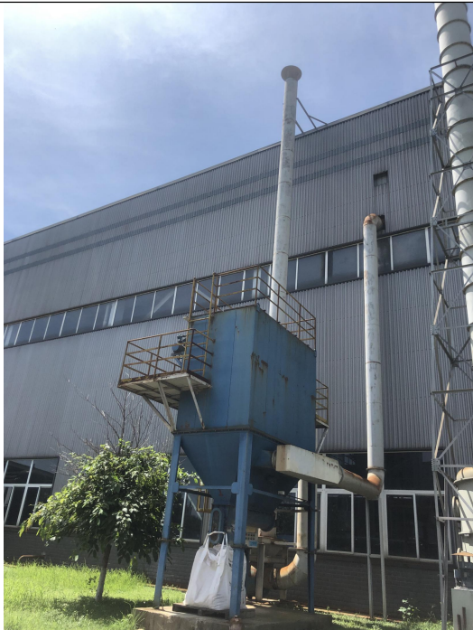
制芯工部加料粉尘处理设施“布袋除尘器”（TA024）+排气筒（DA024）
