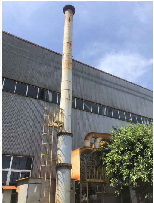
清理工部抛光打磨粉尘处理设施“旋风除尘器+布袋除尘器”（TA025）+排气筒（DA025）
