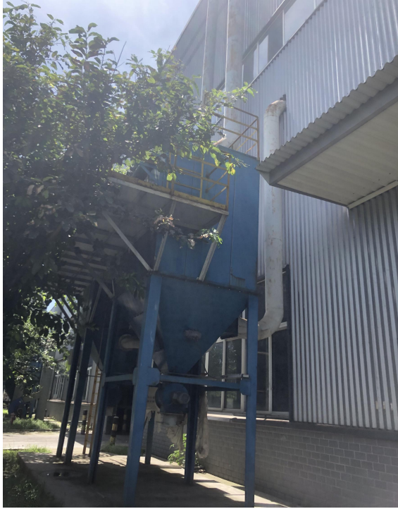
熔化工部加料粉尘处理设施“旋风除尘器+布袋除尘器” (TA018、TA019)+排气筒(DA018左、DA019右)
