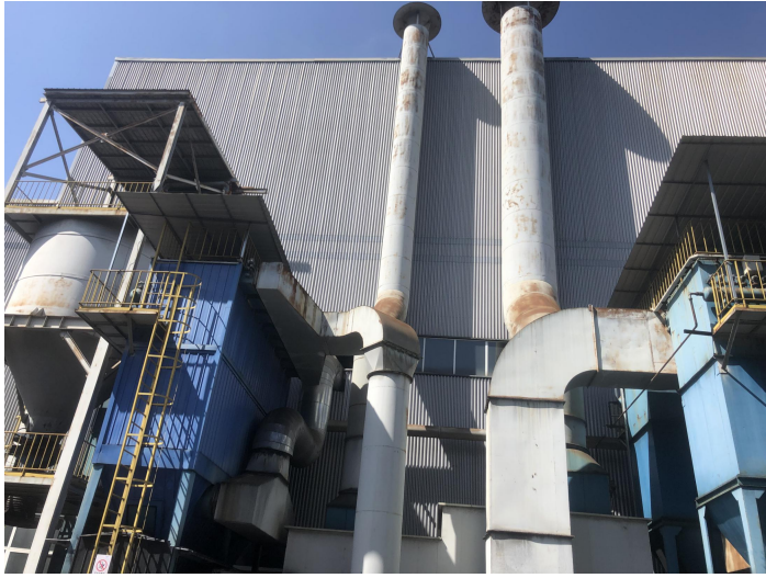
砂处理工部落砂清理、砂处理及再生粉尘处理设施“旋风除尘器+布袋除尘器”（TA002、TA003）+排气筒（DA002Z左、DA003右）
