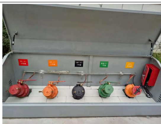
卸油口油气回收
