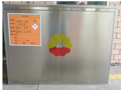
危废暂存设施
