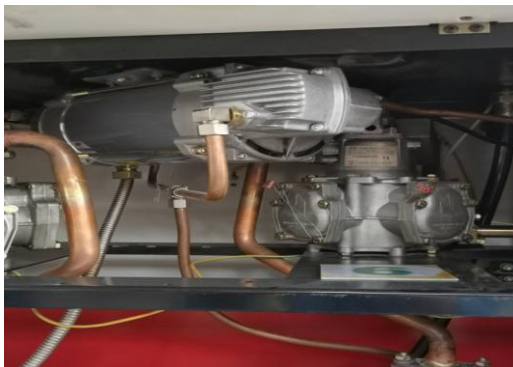
油气回收装置
