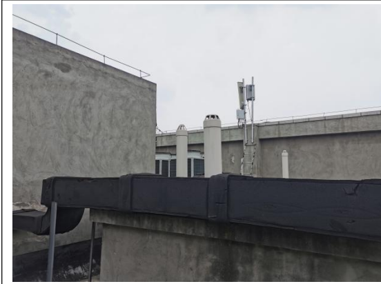
污水处理站恶臭排气筒排口
