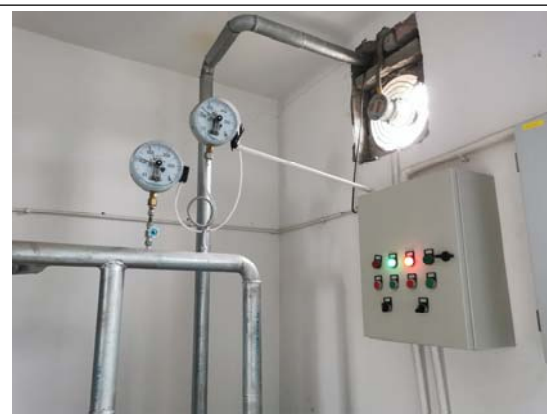
负压废气管道
