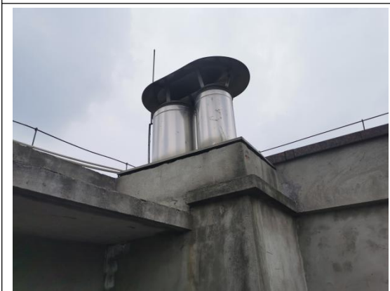
柴油发电机废气排气筒排口
