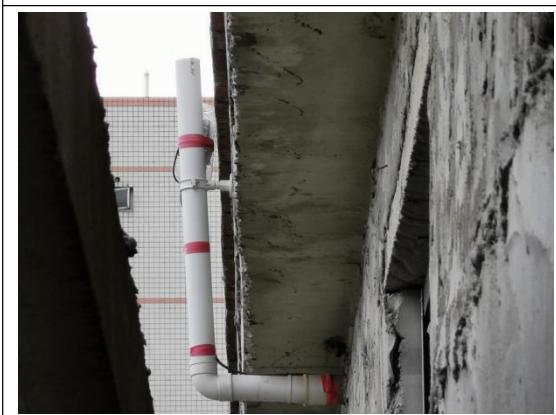
负压废气紫外灯管及排气筒
