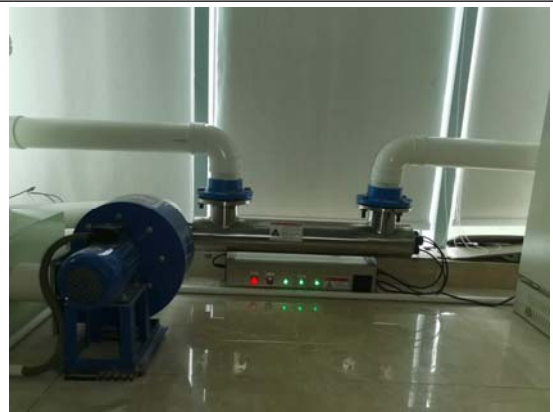
污水处理站紫外灯管
