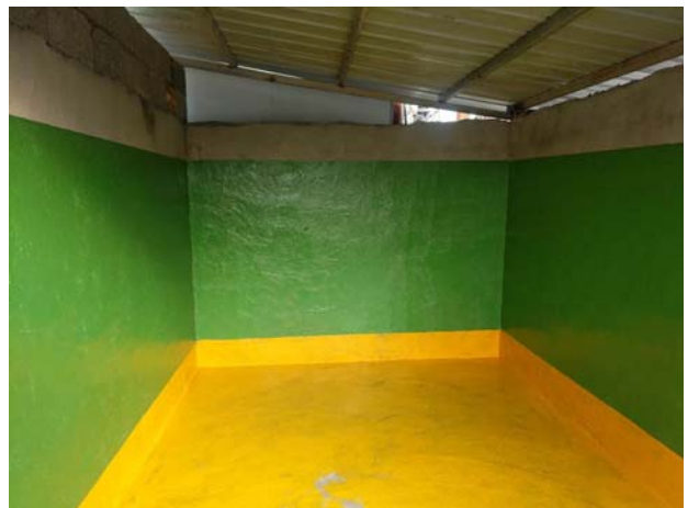
危废暂存间（防渗）
